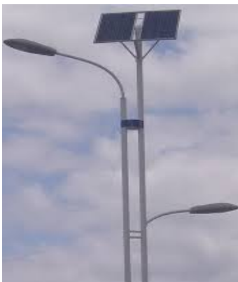
Afbeelding 4.7 Solar LED verlichting
